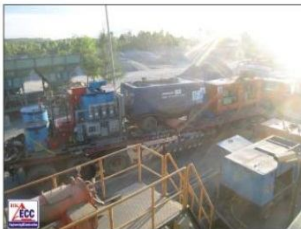
Thiết bị phụ trợ lắp thêm ở trạm trộn để SX BTN Epoxy
